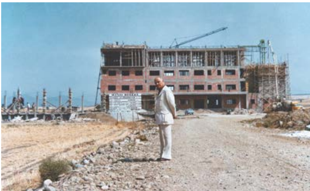
Ο ιδρυτής των «Μύλων Θράκης» Ιωάννης Ουζουνόπουλος κατά την κατασκευή του πλέον σύγχρονου για την εποχή μύλου στην Αλεξανδρούπολη, 1977. Αρχείο Ιωάννη Ουζουνόπουλου.
